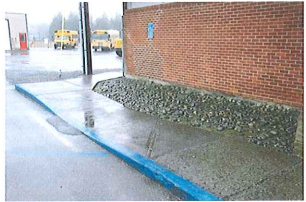
Gymnasium: ADA Curb Ramp is not ADA Accessible
